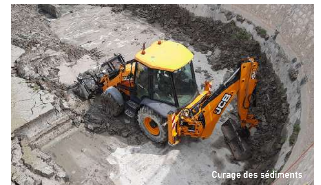
Bassin d'eau brute de l'usine de Super-Rimiez
