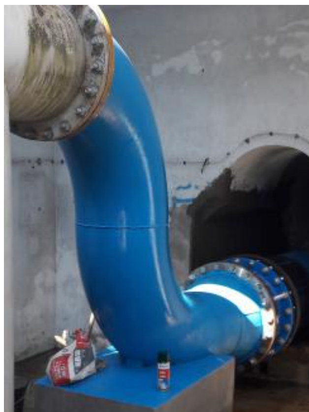
Raccordement sur la marmite existante 1
