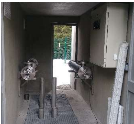
Unité de traitement de Salèze à Saint Martin Vésubie 1
