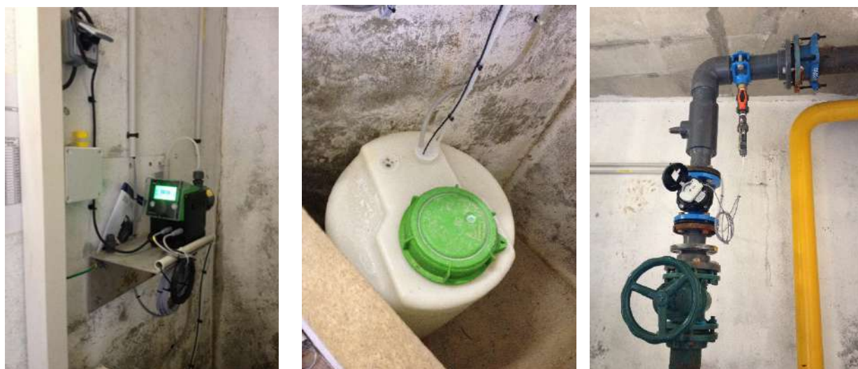
La station de potabilisation du Counigou Inférieur (Roquebillière) désinfecte l'eau de la Source des Imberts.
