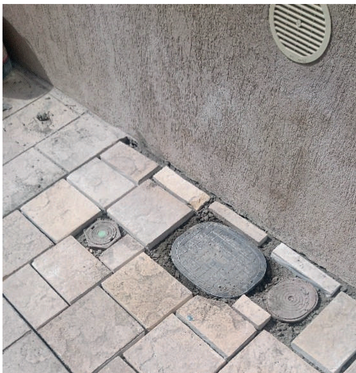
Lantosque : Coffret compteur enterré
