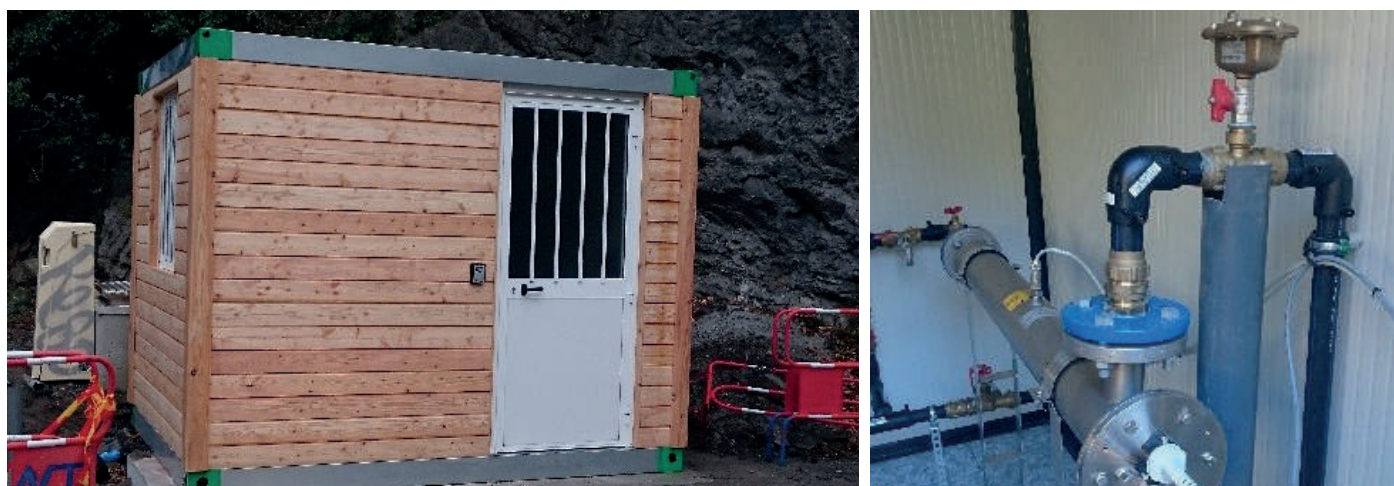
Marie : Unité de traitement par désinfection par UV de La Bollinette
