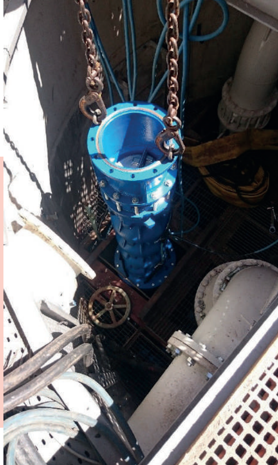
Travaux de réseaux et de mise en place d'équipements de mesure de débits au champ captant des Prairies.
