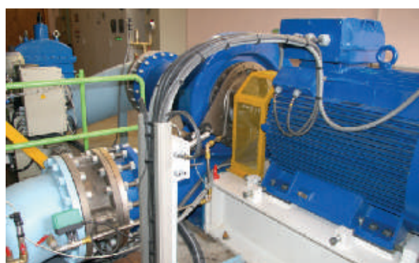
Microturbines installées dans les locaux de Cap de Croix à Nice
