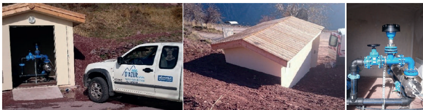
Roure : Système de désinfection par UV installé de la source Rougios
